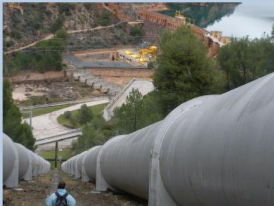
Tubos de impulsión al trasvase Tajo-Segura en Bolarque.
